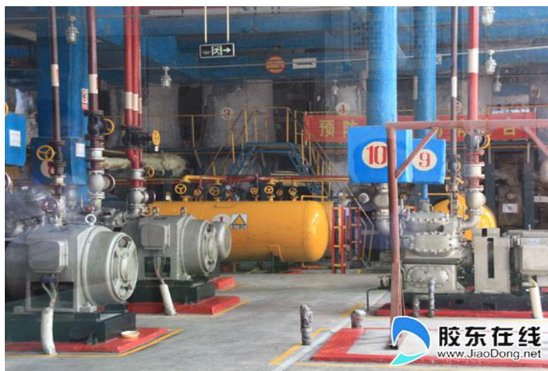
图 22：氨制冷用压力容器压力管道
