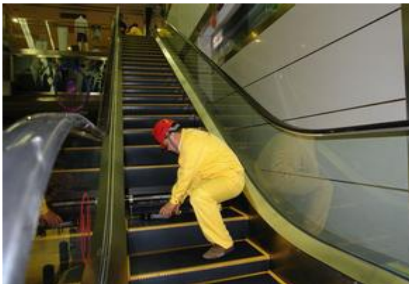
图 23：检验人员在对电梯进行检验
