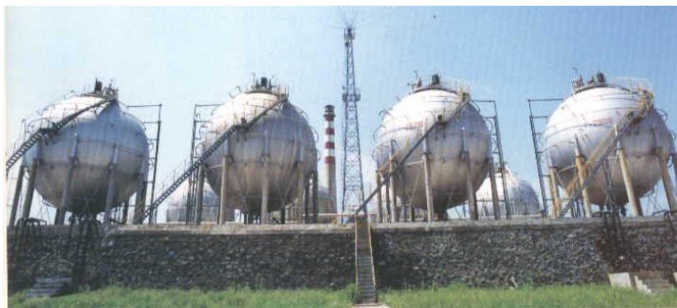
图6：固定式压力容器（球形储罐）
