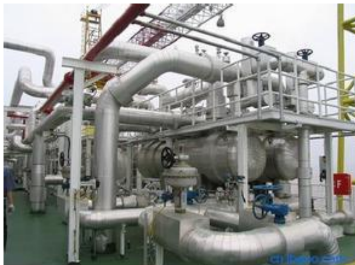
图 9：工业压力管道
