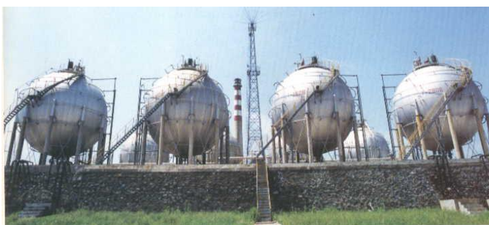
图 6：固定式压力容器（球形储罐）
