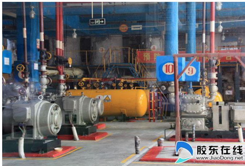
图 22：氨制冷用压力容器压力管道
