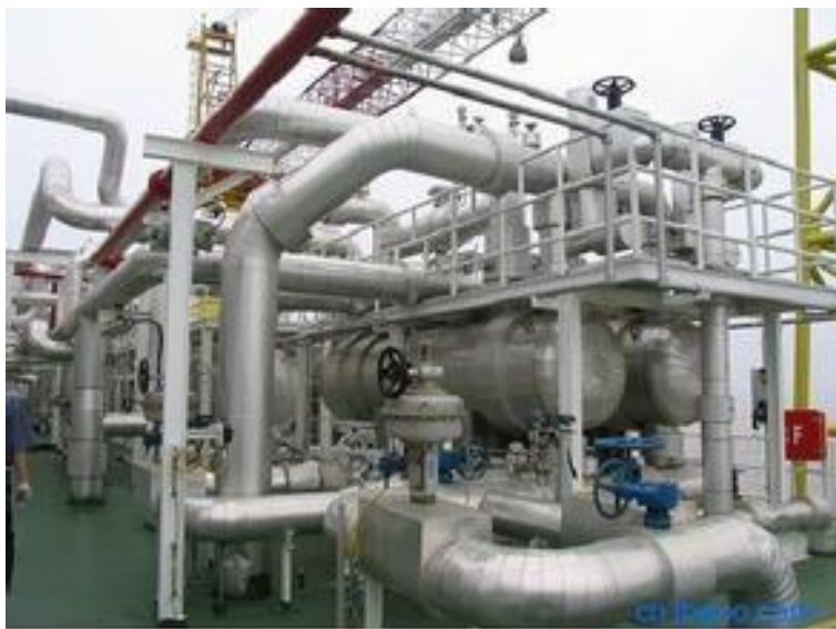
图 9：工业压力管道
