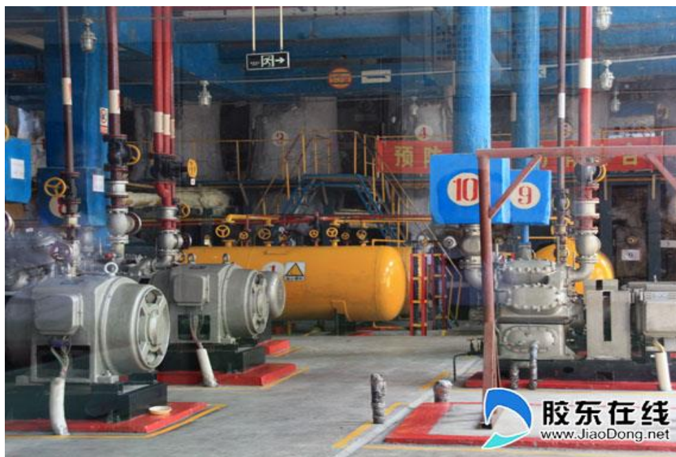
图 23：氨制冷用压力容器压力管道
